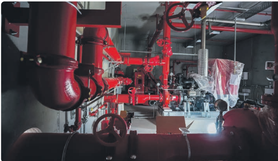
Die Sprinkleranlage von Etol wurde auf den aktuellen Stand der Technik gebracht.
